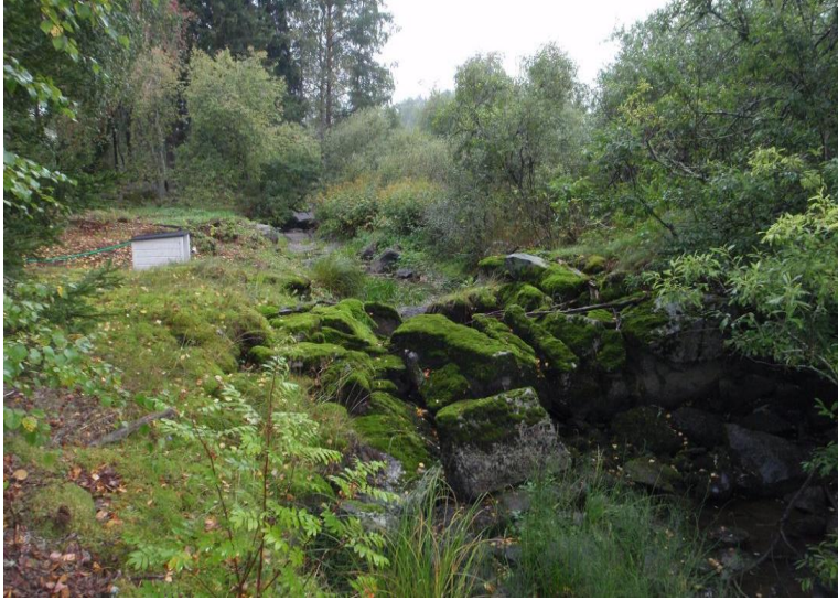
Kuva 7. Pisteessä P15 oleva kivisillan raunio estää kalojen vaelluksen.
