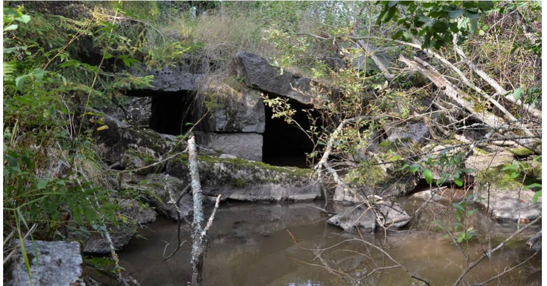
Kuva 25. Maantien kaksiaukkoisesta, suurista lohkokivistä rakennetusta sillasta on pudonnut jokeen kiviä ja kaiteiden betonipilareita. Kuva otettu sillan pohjoispuolelta.
