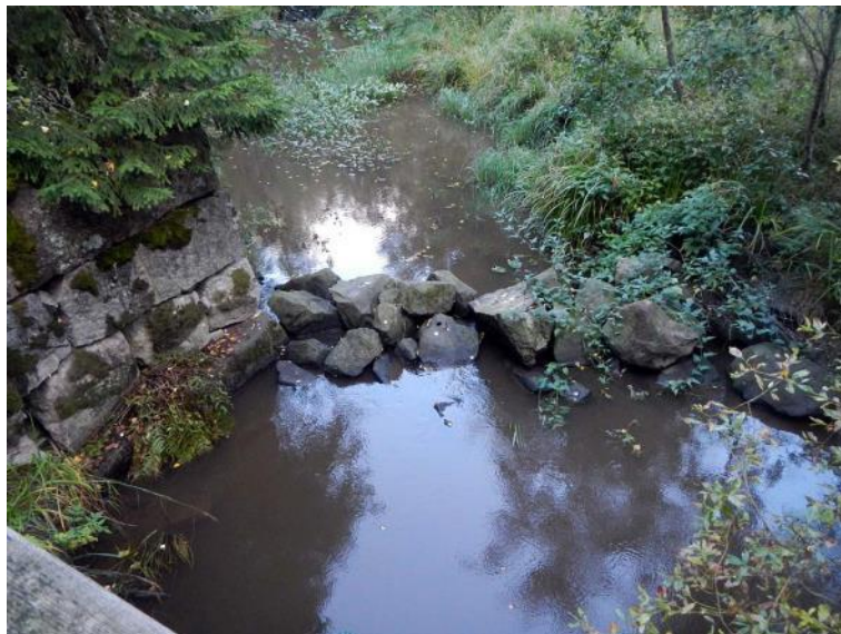
Kuva 21. Nuorempi kivipato sillan luoteispuolella.
