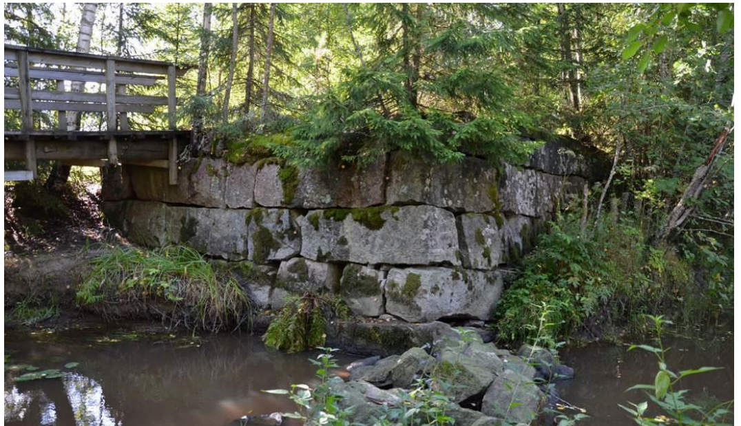
Kuva 4. Laidetien sillan lohkokivistä rakennettu pitkä penger ja nykyinen kevyen liikenteen puusilta. Etualalla näkyy joen virtauksen hidastamiseksi tehty nuorehko kivipato. Sillan kivrakenteiden läheisyydessä kasvava puusto olisi hyvä poistaa rakenteen säilymisen turvaamiseksi. Kuva otettu joen pohjoispuolelta.
