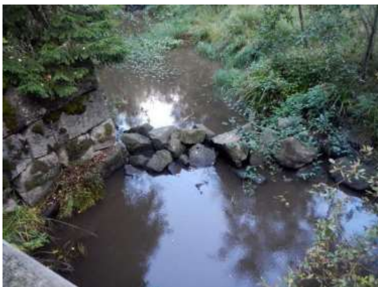
Kuva 21. Nuorempi kivipato sillan luoteispuolella.
