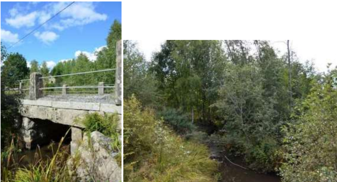
Kuva 18 (Kuvat). Vas. Vanhaan Kikkerlängtien yksiaukkoinen kivililta on rakennettu suurista lohkotuista kivistä kylmämuuraamalla. Sillan yläosassa on käytetty paremmin käsiteltyä kiveä ja kaiteiden pylväiden kulmat on hienohakattu. Oik. Sillan kupeeseen v. 1907 karttaan merkitystä myllystä ei löytynyt näkyviä jäänteitä.
