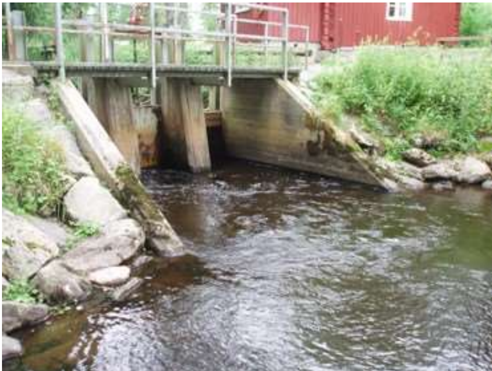
Kuva 59. Tammen säännöstelypato Joutsijärven luusuassa
